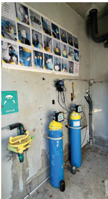
Local chloration Piscine Poséidon
